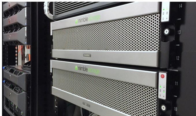
Die Nimble Storage CS 300 & ein H45 Shelf.
